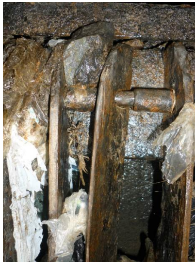
Figura 3: Barras de reja rotas y desalineadas
