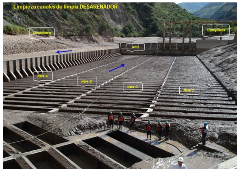
Vista general de Desarenador.
