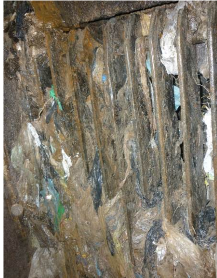
Figura 4: Reja colmatadas con residuos plásticos y ramas
