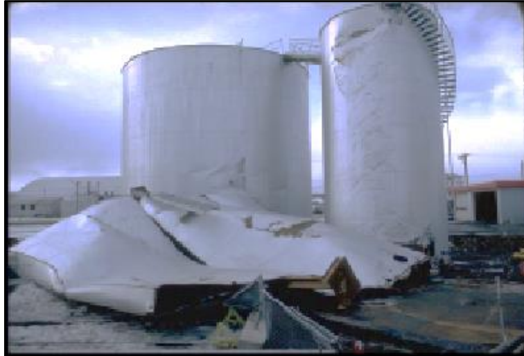
Figura 1.2. Falla por colapso
