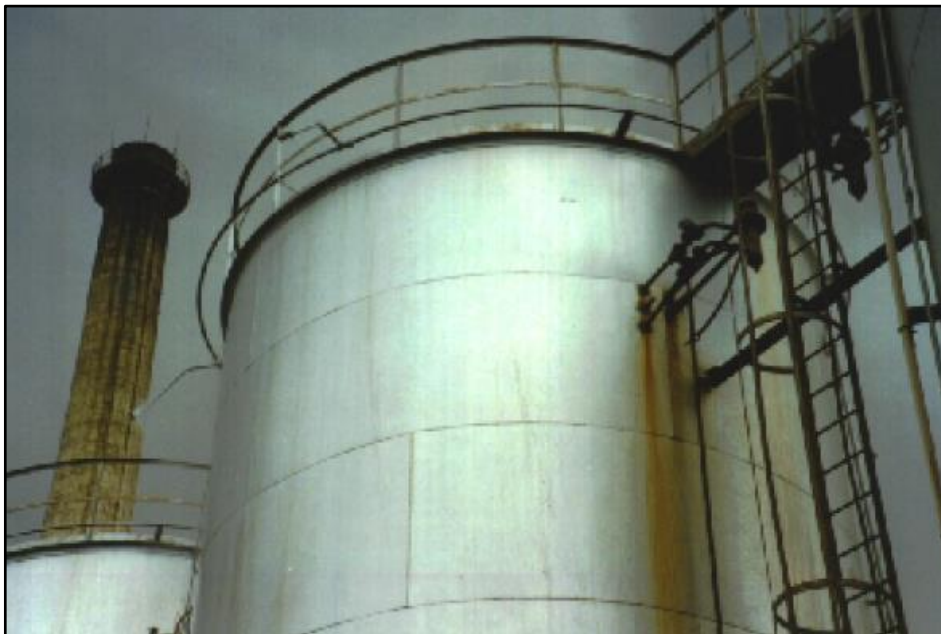
Figura 1.3. Corrosión en el exterior del tanque. (Pasante)
