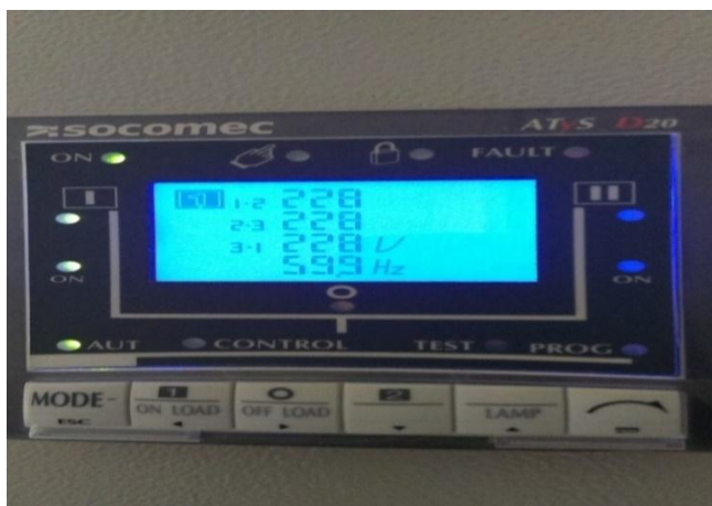
Figura N°25. Panel operador de tablero de transferencia automática
