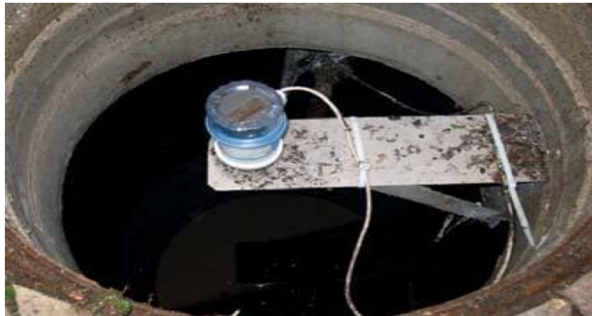
Figura N°6: Sensor de Nivel instalado en un tanque
